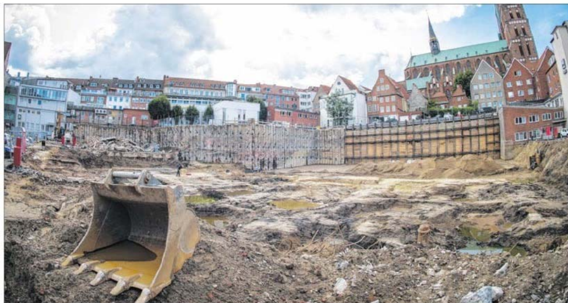
Große Baugrube: Im Wehdehof wird ein neues Parkhaus gebaut. Jetzt gibt es Ärger mit der Archäologie.
