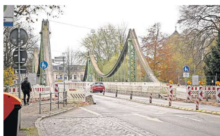
Die Mühlentorbrücke ist völlig verrostet und schon seit 2019 teilweise gesperrt. FOTO: AGENTUR 54°
